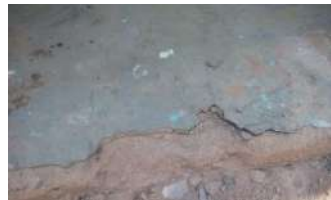
Peeled VIP Toilet floor
