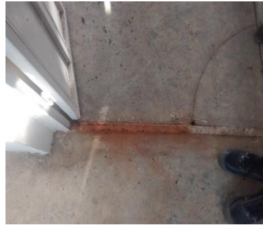
Rust on bottom door frame
