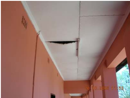
Falling ceiling board – Kafue hostel
