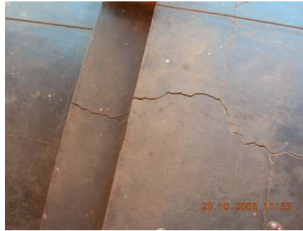
Cracked floor not attended to-Kafue Hostel
