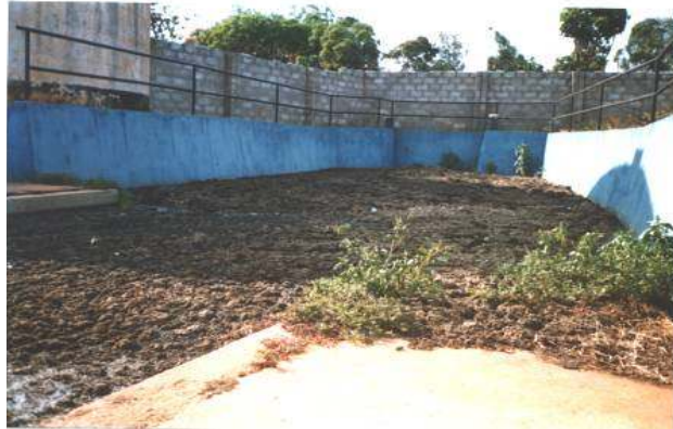
Caked sewer effluent
