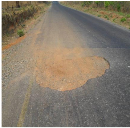
Pothole at Km 33.6 on the Kafue – Mazabuka Road
